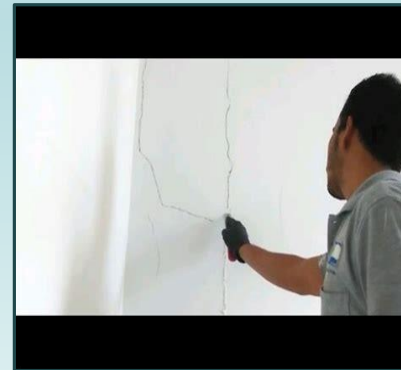
Evaluación de la Fuga por Grieta
